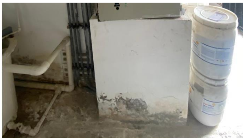
Imagen 8. Deterioro de muros y placa de concreto.
