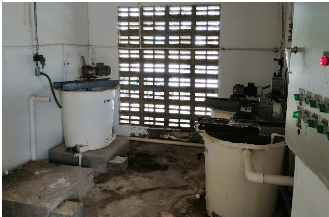
Imagen 7. Cuarto de tanques de dosificación.
