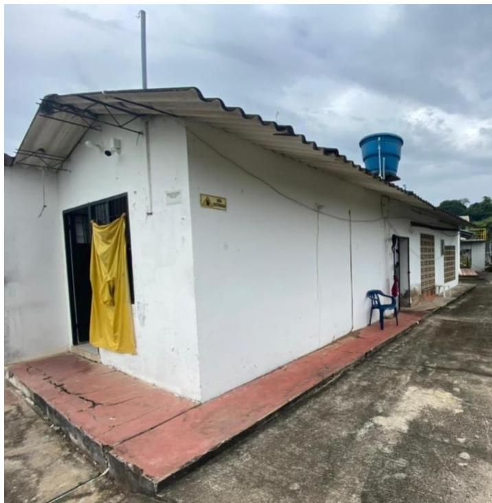
Imagen 10. Grietas en la placa de contrapiso exterior.
