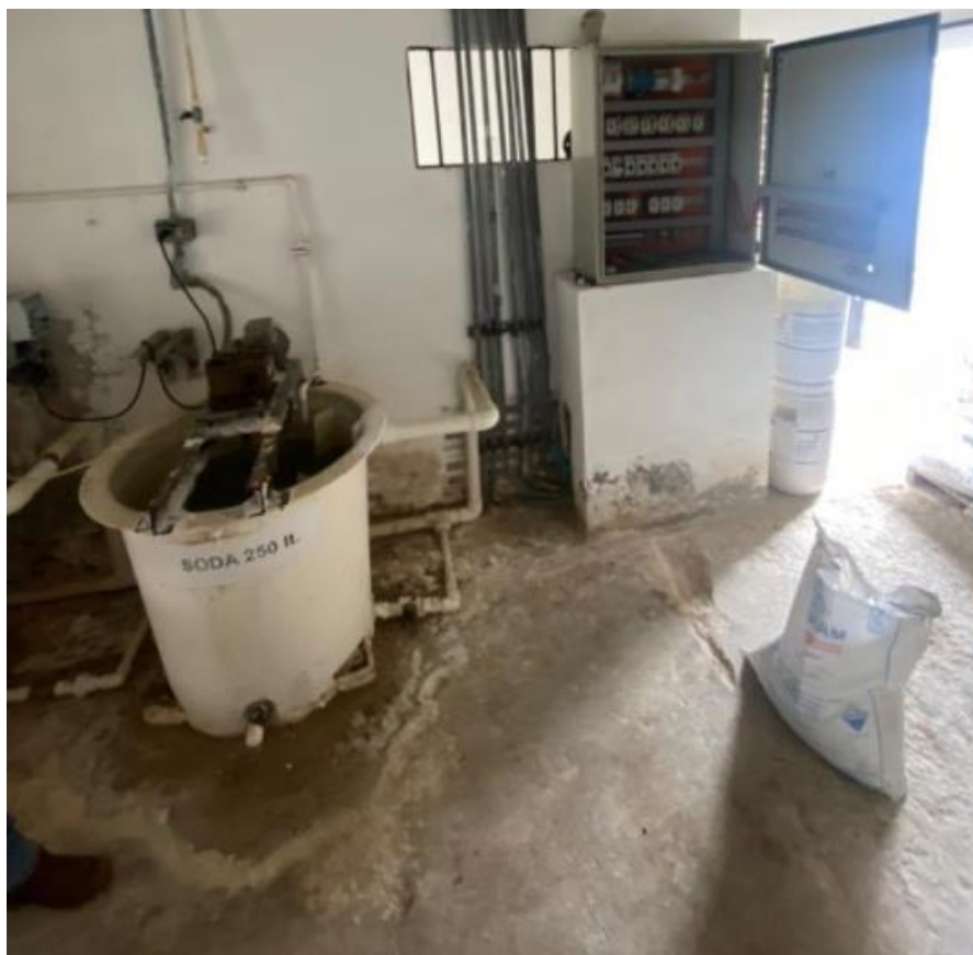
Imagen 3. Tanque de dosificación de soda así.
