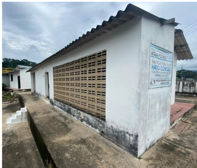
Imagen 9. Deterioro de muros exteriores.
